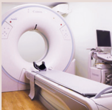
CT検査設備
